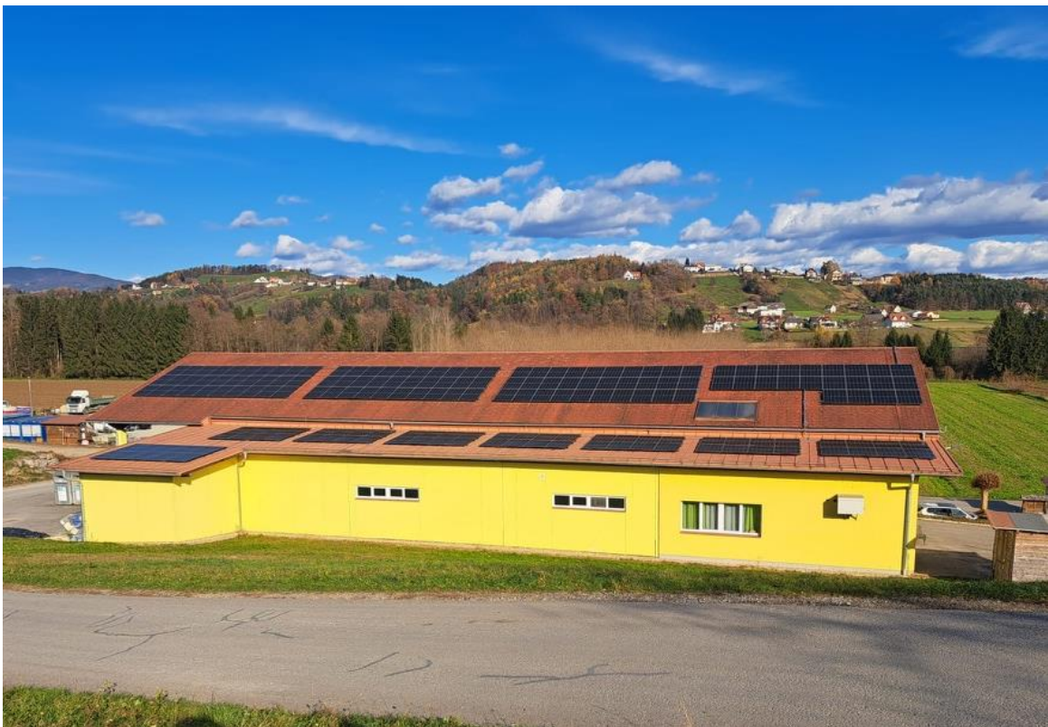
Abbildung 1: 102 kWp PV-Anlage auf dem ASZ © Gemeinde Mitterdorf an der Raab
